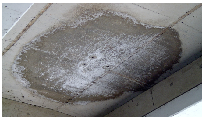
Figure 4 : Illustration d'une tache due aux dégradations
