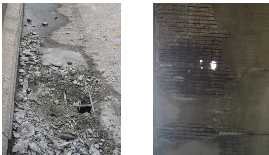
Figure 1 : Percements de la dalle du tablier du pont de la Zone V à Charleroi
