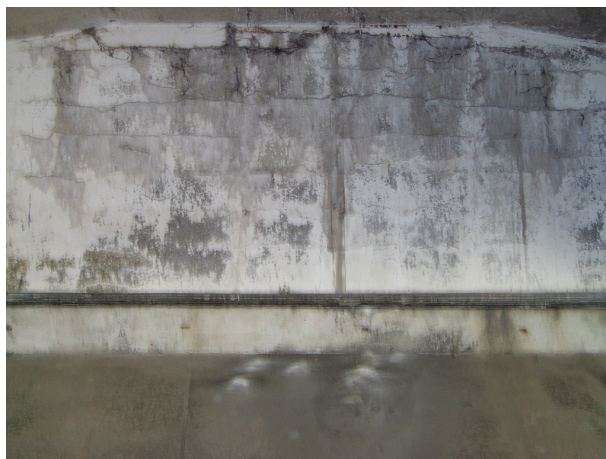
Figure 5 : RAG dans un sommier de pont
